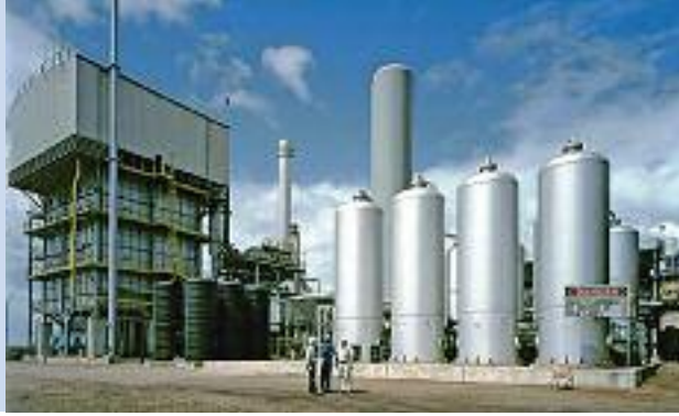
Air Liquide Hydrogen Unit, Trinidad
