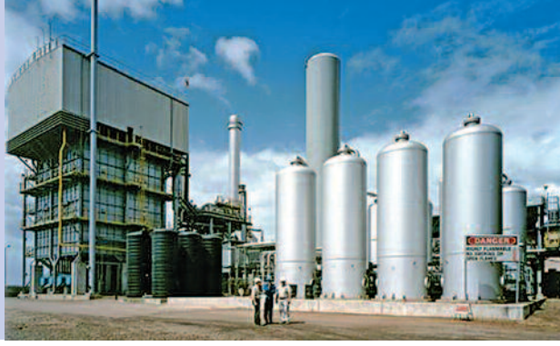
Air Liquide Hydrogen Unit, Trinidad
