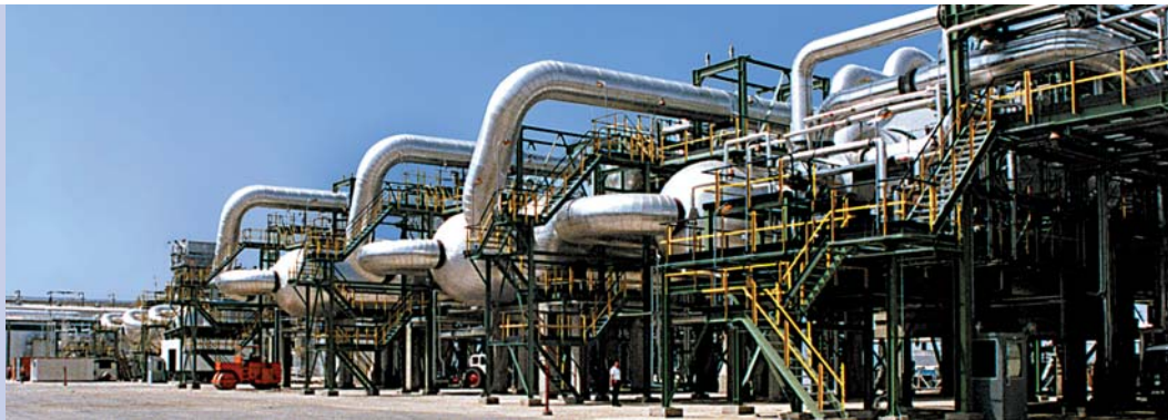
1000 t/d Claus-Sulfreen Plant
